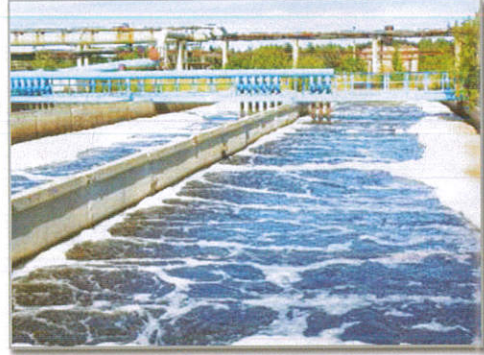
บ่อบ่อดนน้ำเสย
