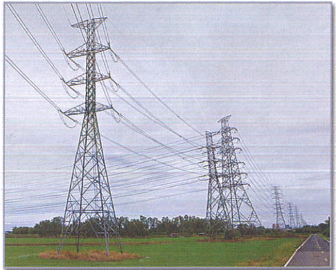
เสาไฟฟ้า
